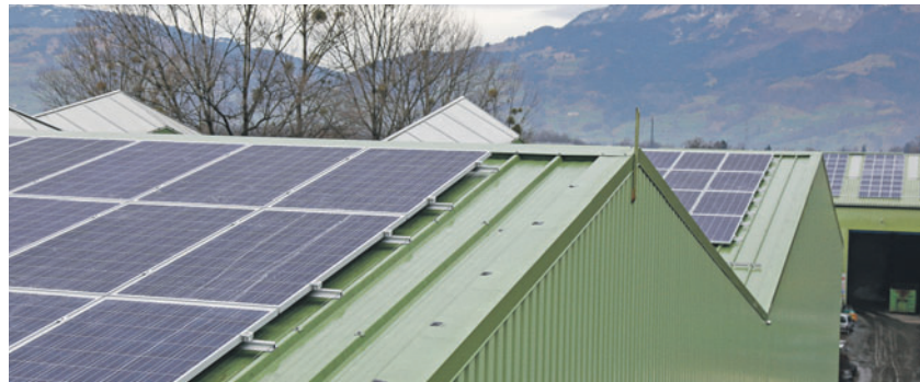
Das Foto zeigt das Dach des Recyclingcenters Josef Elkuch AG in Eschen mit der Photovoltaik-Anlage, die 2015 in Betrieb genommen wurde. (Foto: P. J. Trummer)
